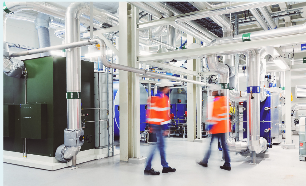
Kalnes energisentral gir varme og kjøling til Sykehuset Østfold
