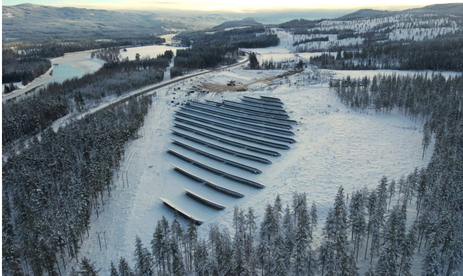
Første del av Furuset solkraftverk i Stor-Elvdal kommune ble koblet på nettet i 2023.
